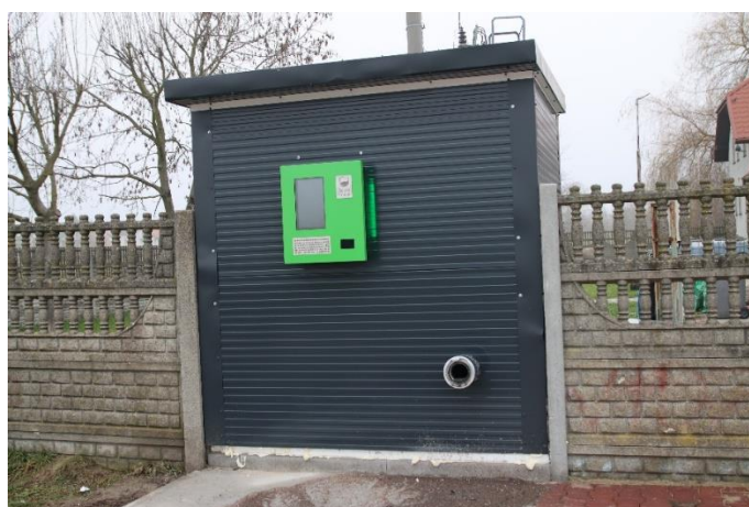
punkt zlewny ścieków dowożonych
