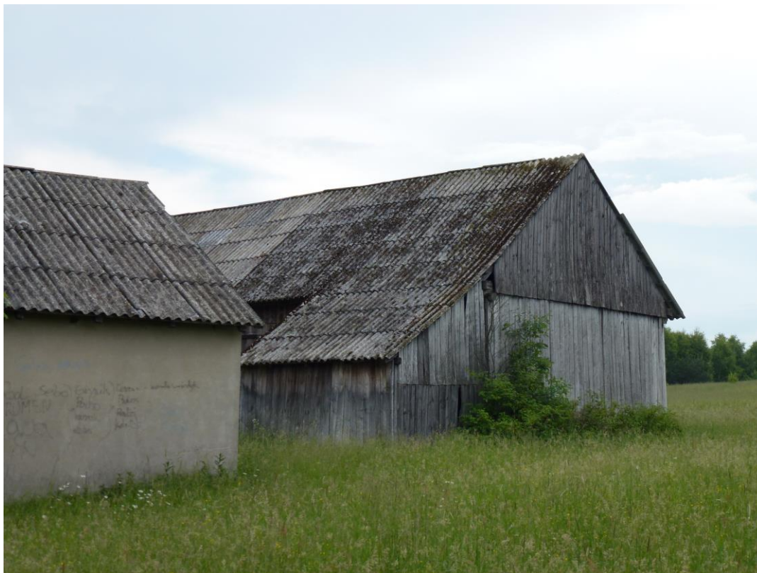
Rys. 9. Budynki pokryte azbestem falistym (Źródło: Fotografia własna)
