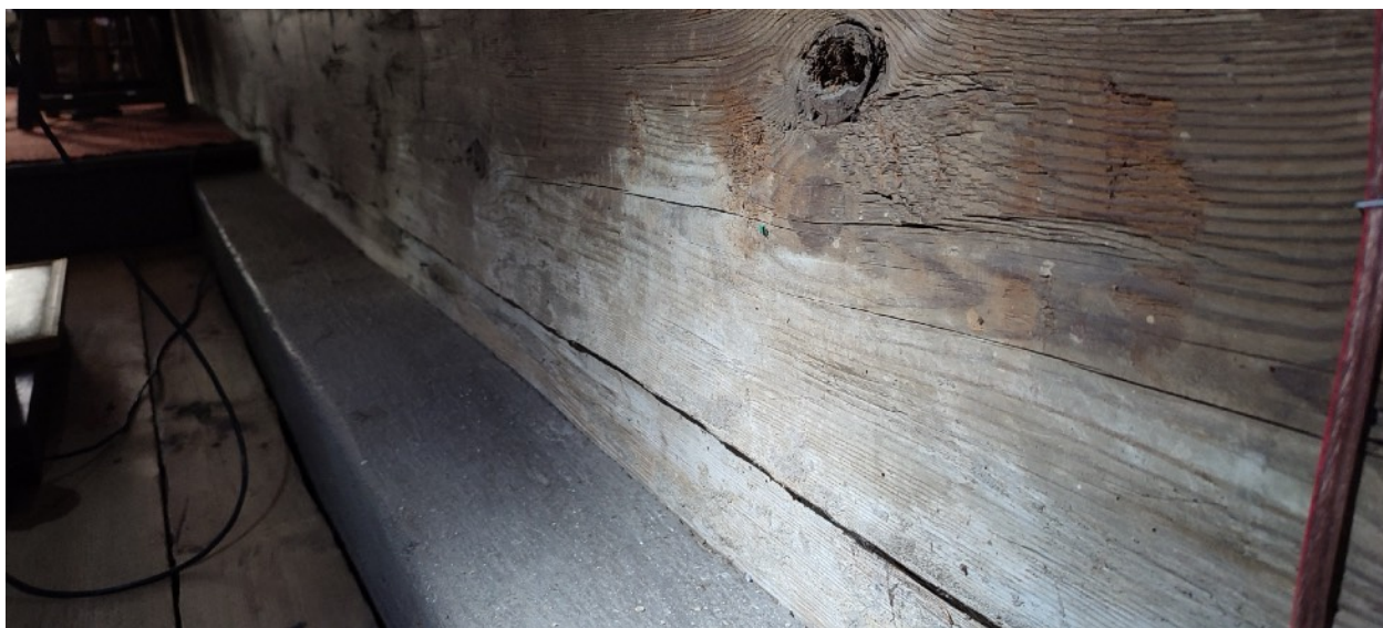
Rys 22. Zabrudzenie ściany południowej prezbiterium w miejscu oparcia na podwalinie
