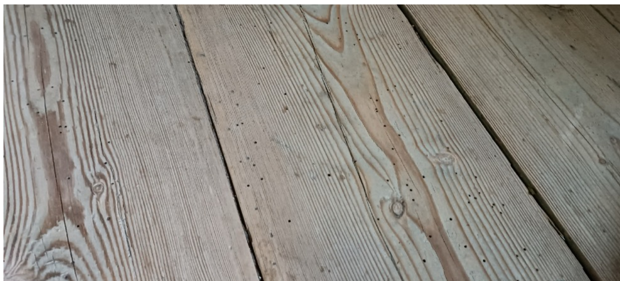
Rys 25. Wyloty chodników owadzich w deskach podłogi
