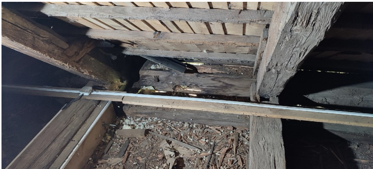
Rys 19. Zniszczenia w rejonie oparcia więźarów na belkach gzymsowych
