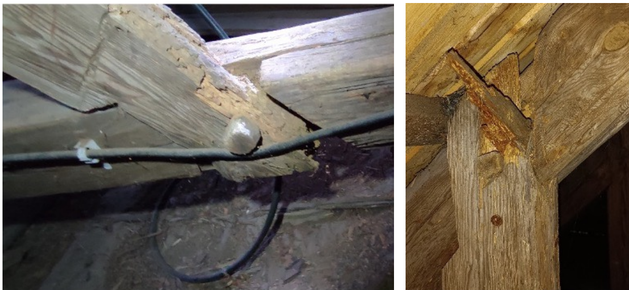
Rys 14. Uszkodzenia złączy ciesielskich
