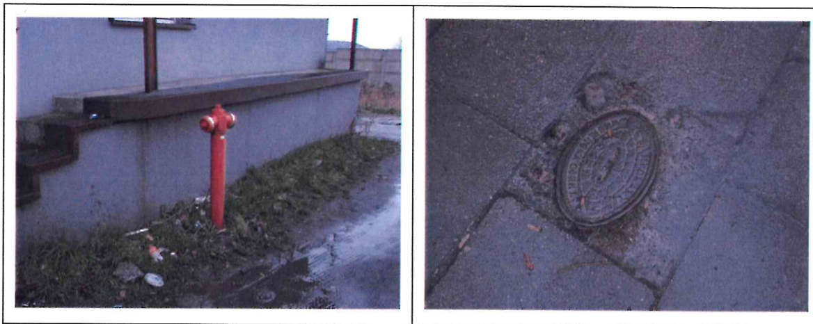
Hydranty zewnętrzne stanowiące przeciwpożarowe zaopatrzenie wodne dla budynku
