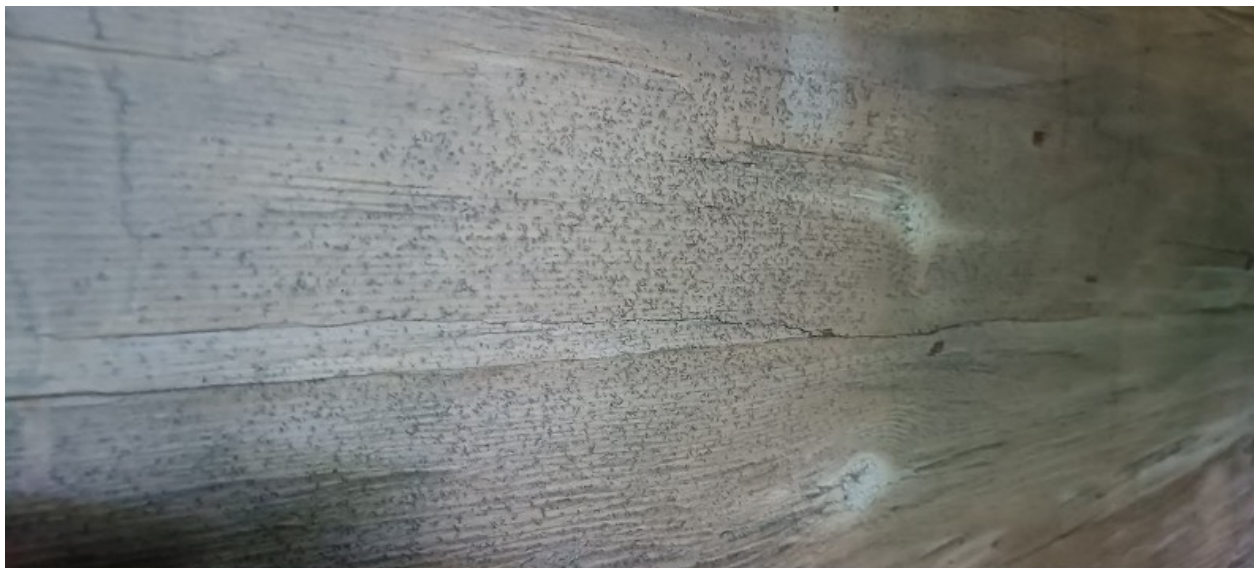
Rys 32. Grzyby pleśniowe na powierzchni wewnętrznej ściany
