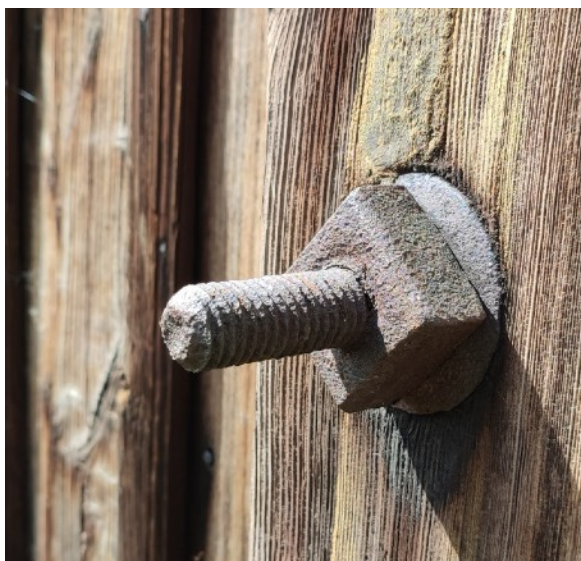
Rys 21. Korozja metalowych ściągów lisic
