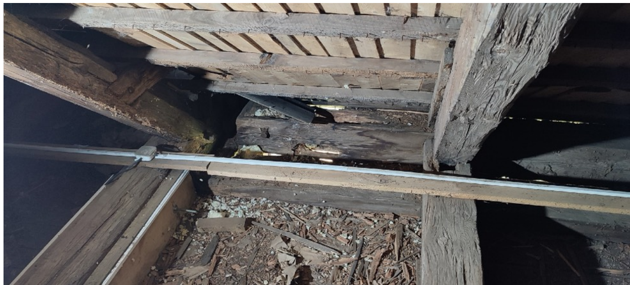
Rys 19. Zniszczenia w rejonie oparcia wiązarów na belkach gzymsowych
