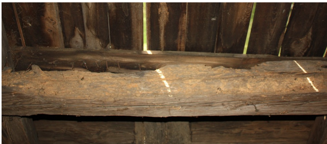
Rys 13. Ubytek przekroju belki ściany szczytowej zachodniej poddasza
