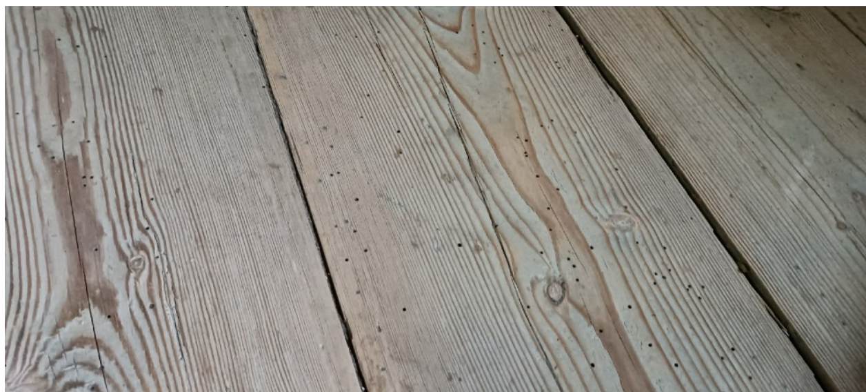
Rys 25. Wyloty chodników owadzich w deskach podłogi
