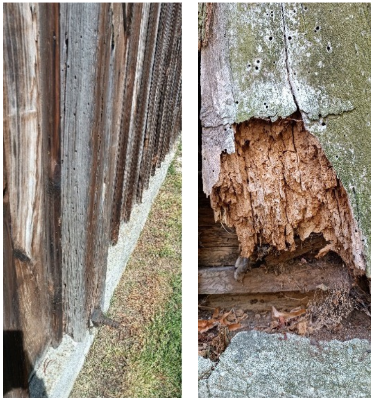
Rys 28. Otwory wylotowe chodników owadzich w lisicach oraz zniszczenie dolnej części deski szalunkowej
