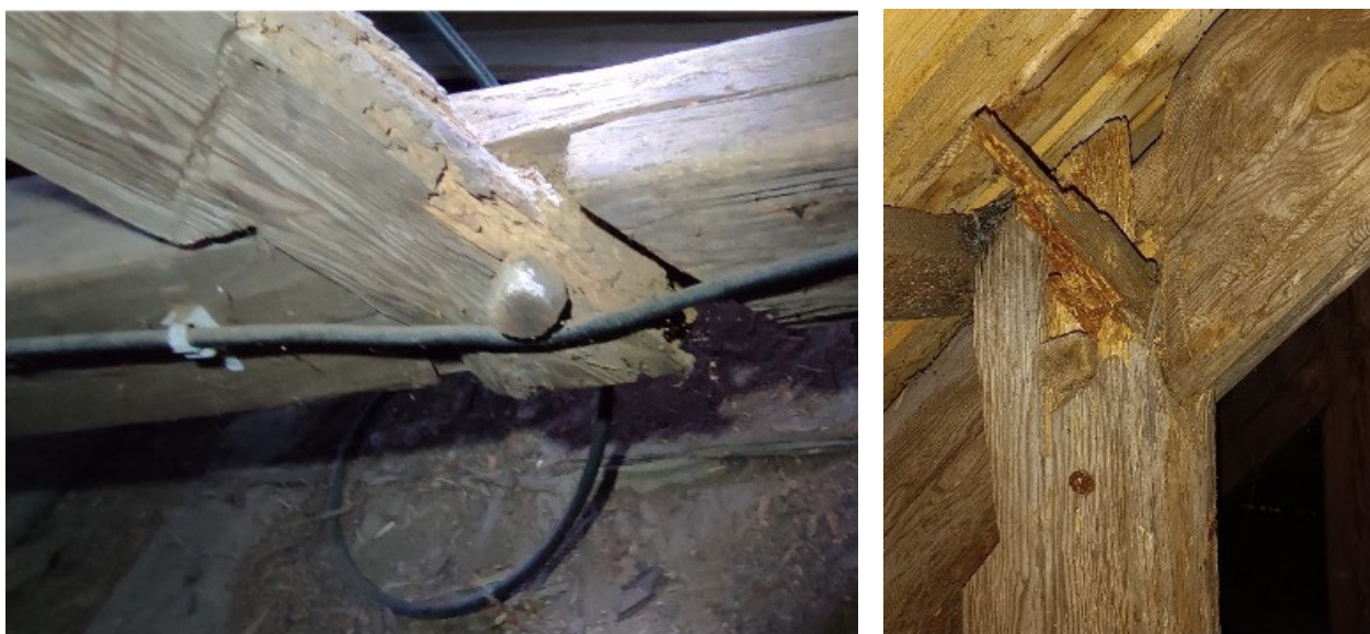
Rys 14. Uszkodzenia złączy ciesielskich
