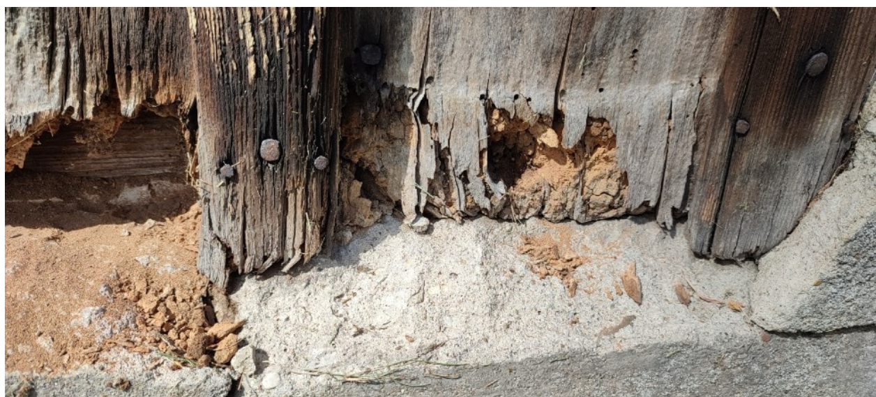
Rys 20. Degradacja desek szalunkowych ścian w rejonie styku z podwaliną
