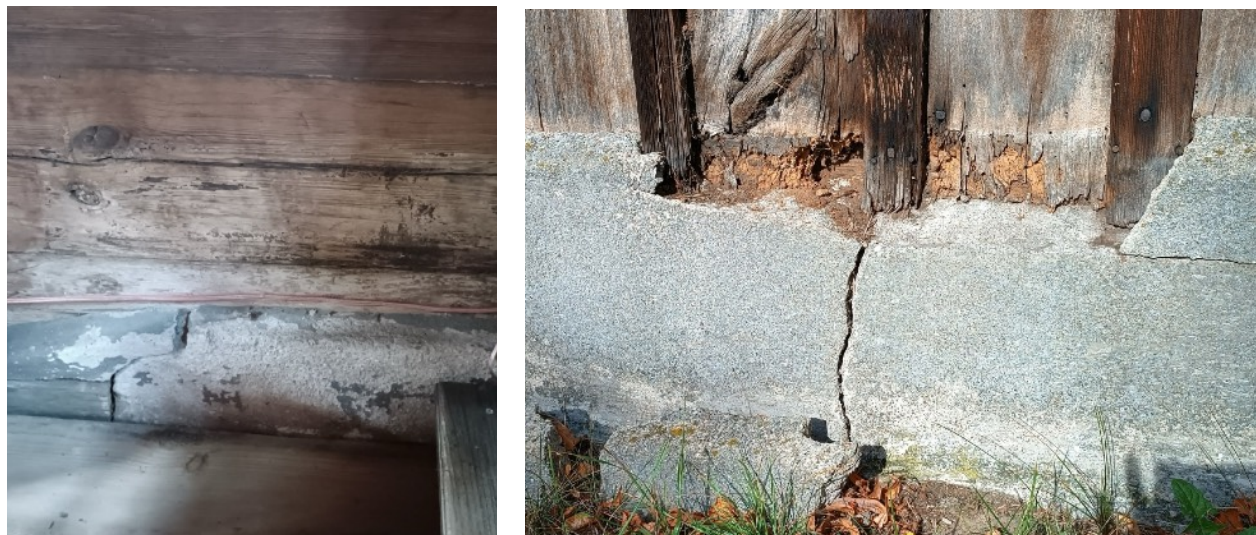
Rys 26. Pęknięcia oraz odłupania betonowych belek podwalinowych
