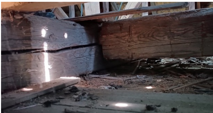
Rys 16. Korozja biologiczna belek wiązarowych (zdjęcie z lewej)
