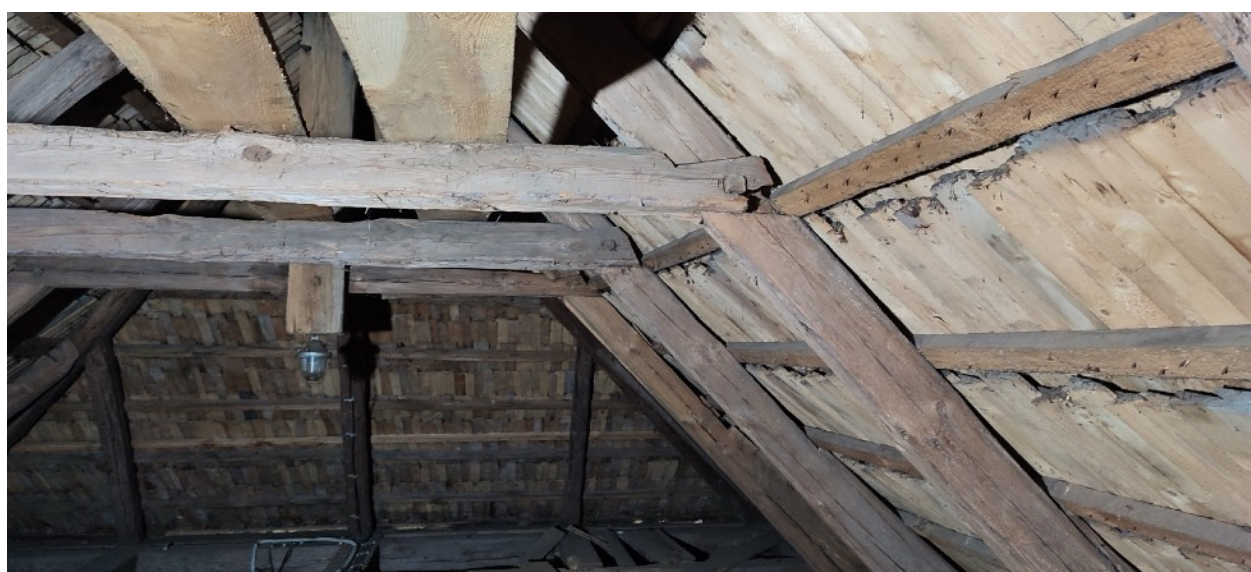
Rys 11. Uszkodzenia wiązarów jętkowych nad prezbiterium
