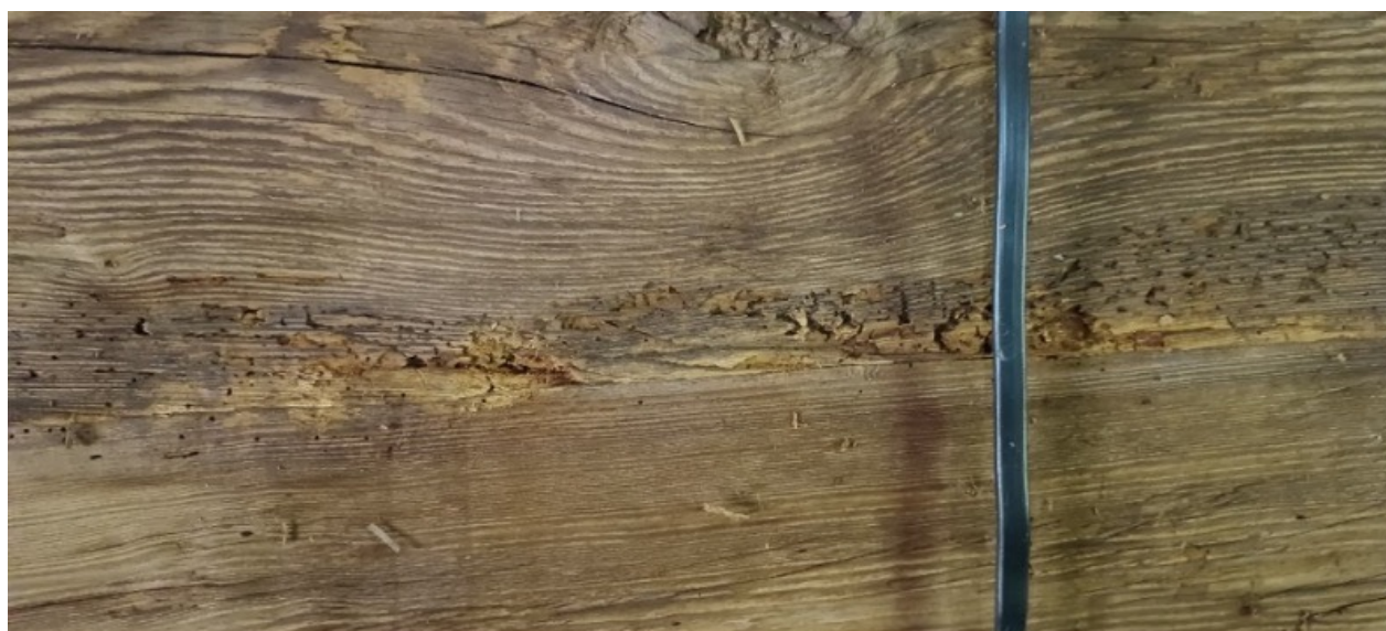
Rys 29. Otwory wylotowe chodników owadzich wewnątrz kościoła (w belkach ścian)
