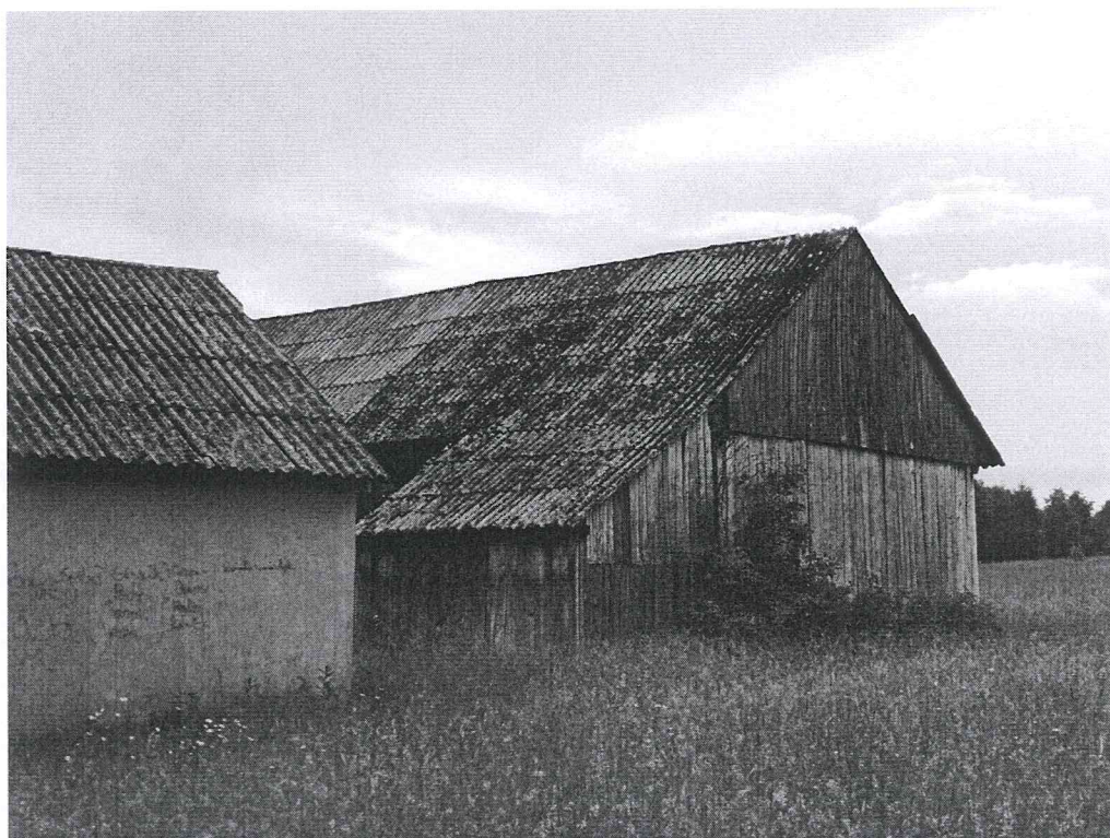
Rys. 9. Budynki pokryte azbestem falistym (Źródło: Fotografia własna)
