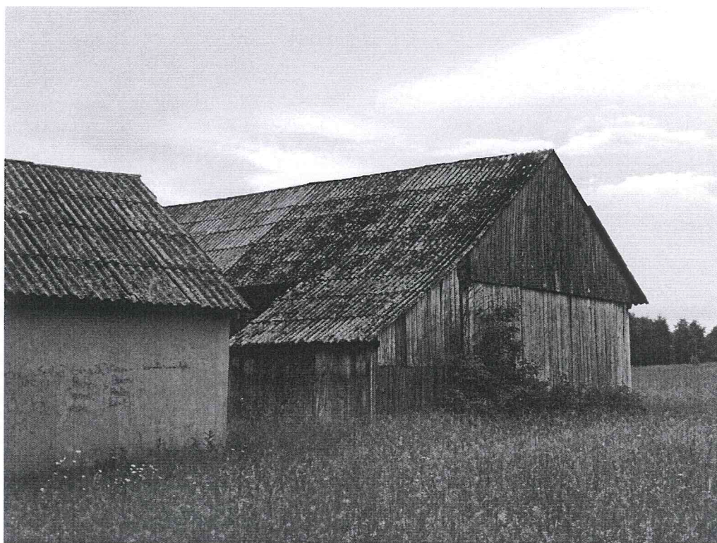
Rys. 9. Budynki pokryte azbestem falistym (Źródło: Fotografia własna)
